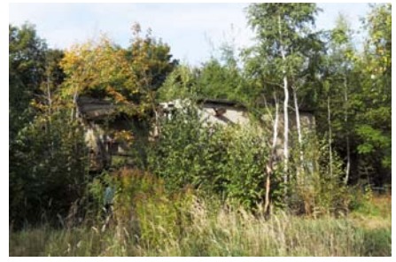
(4): leerstehendes Wirtschaftsgebäude, marode Gebäudesubstanz
