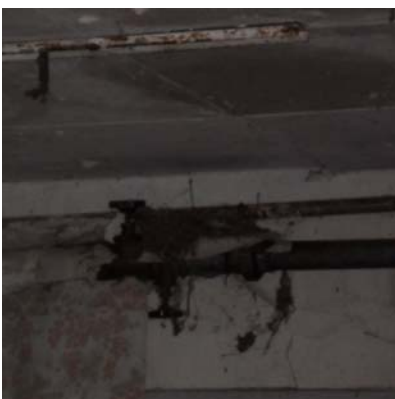
(12): Reste Nistmaterial auf alten Rohren
