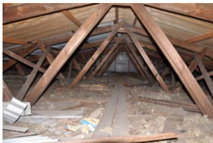
(9): Dachboden mit Holzbalken, Marderkot
