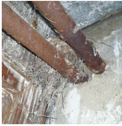
(3): Amsel: altes Nest auf Rohrleitung
