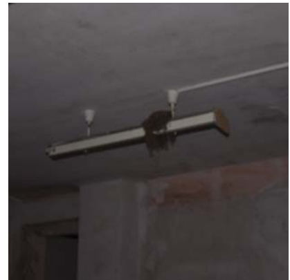
(5): 1. OG: älteres Nest auf Deckenleuchte
