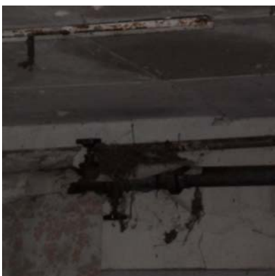
(12): Reste Nistmaterial auf alten Rohren
