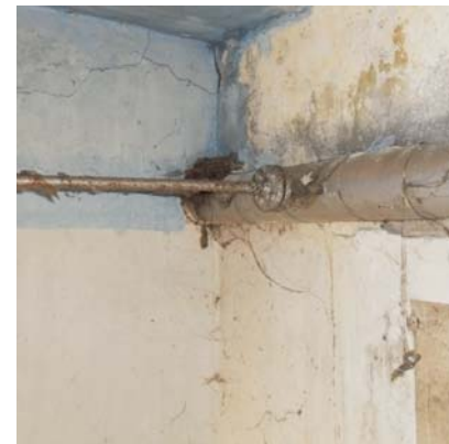
(12): altes Nest auf alter Rohrleitung
