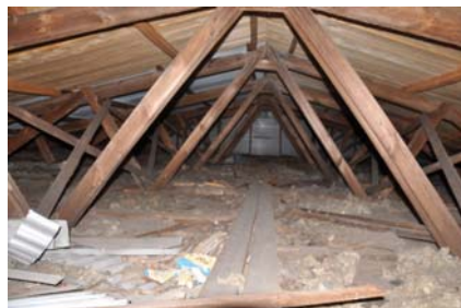
(9): Dachboden mit Holzbalken, Marderkot
