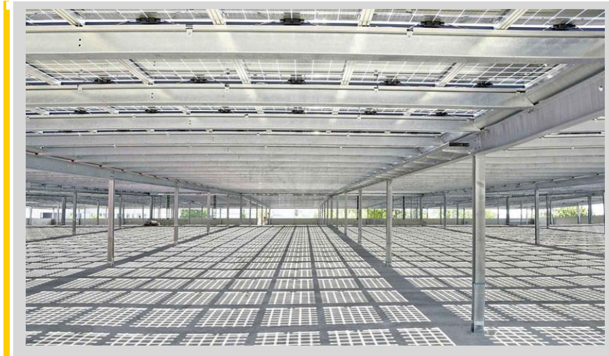
Abbildung 4.11: Parkhausüberdachung mit bifazialen PV-Modulen, Quelle: Solarwatt
