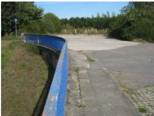
Erschließungsmängel Cröbernsche Straße über Pleiße
