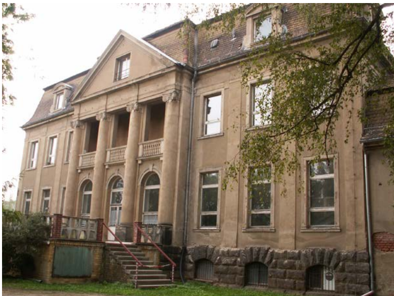
Gutsgelände Gaschwitz ehemaliges Herrenhaus stark sanierungsbedürftig
