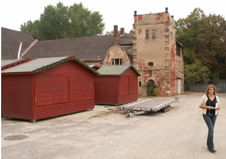
Gutsgelände Gaschwitz ehemaliger Schafstall stark sanierungsbedürftig
