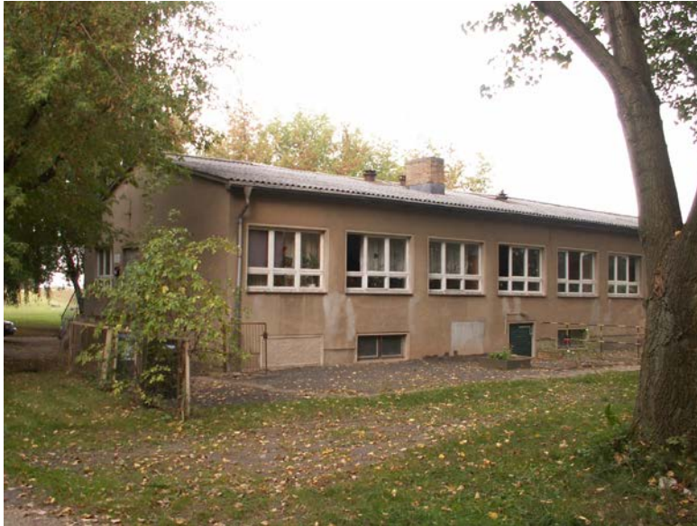
Cröbernsche Straße/ Gutshofpark bestehendes Jugend- und Begegnungszentrum stark sanierungsbedürftig
