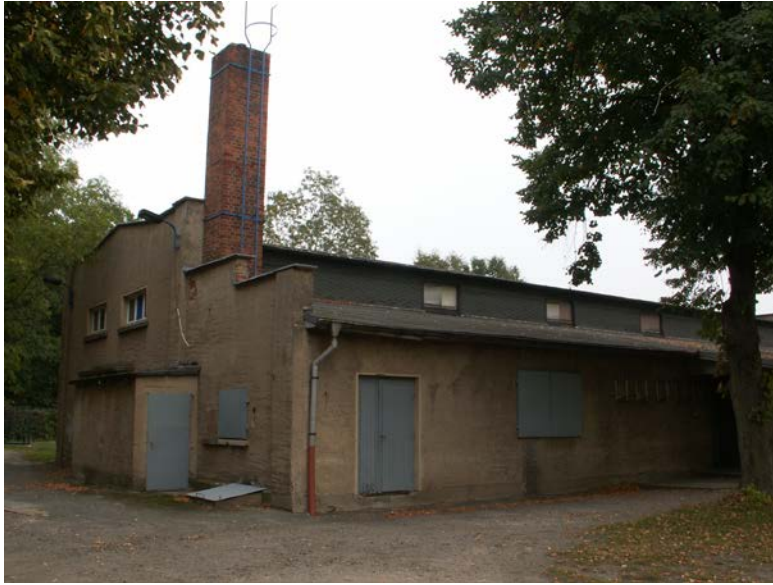
Hauptstraße (Gaschwitz) "alte Turnhalle" stark sanierungsbedürftig
