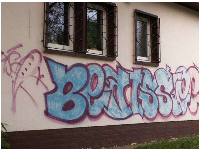
Alte Straße (Rückseite Eiscafé "Venezia") Vandalismus
