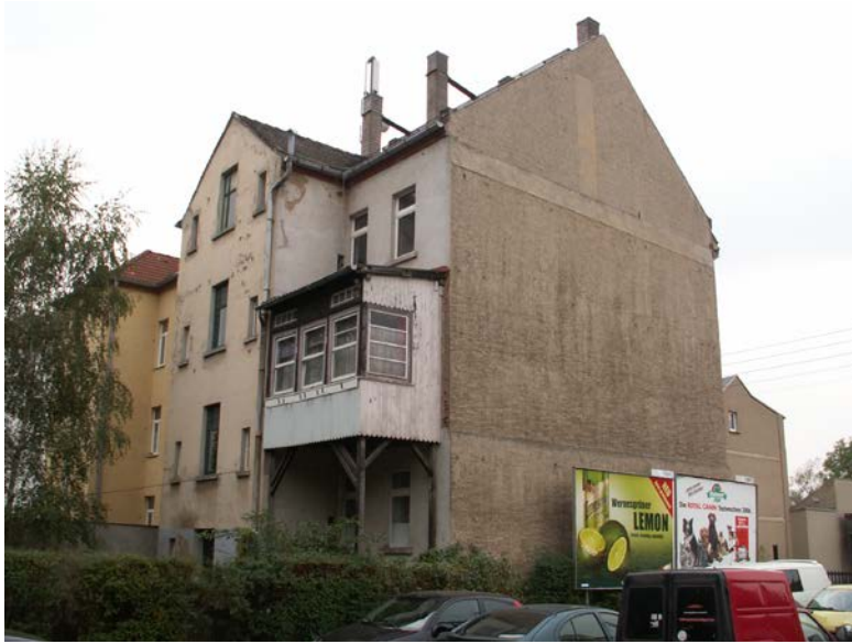
Hauptstraße (Gaschwitz) notwendige Sanierung
