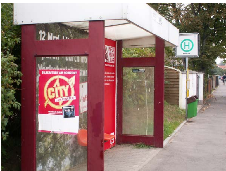
Hauptstraße (Großstädteln) unattraktive Bushaltestelle, Vandalismus
