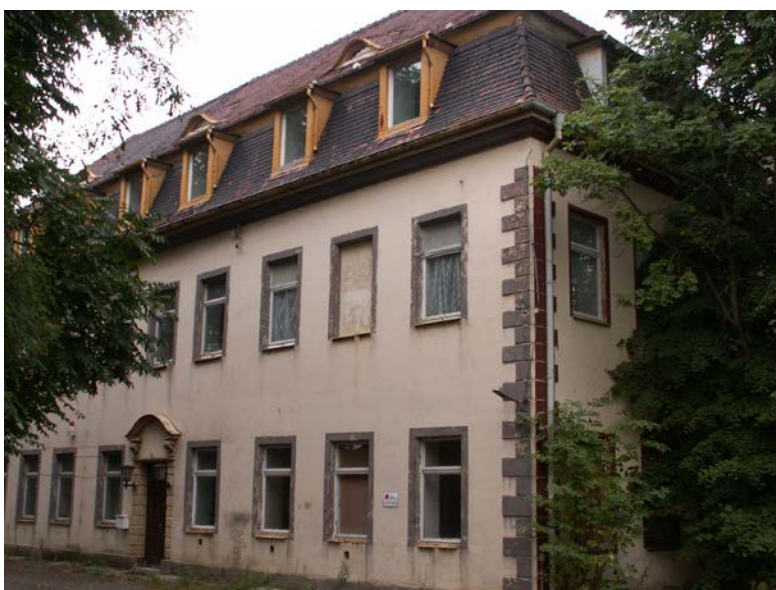
Schloss Großstädteln (priv.) Leerstand, erheblicher Sanierungsbedarf Gebäude, Torhaus, Außenanlagen
