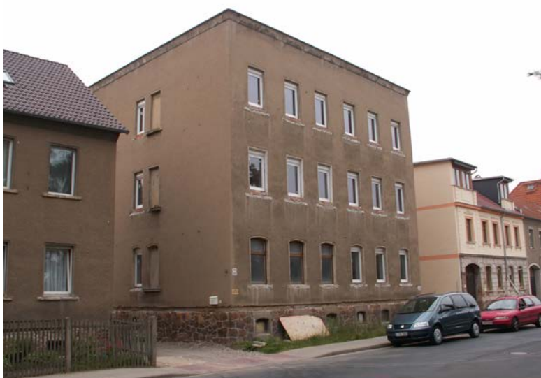
Hauptstraße (Gaschwitz) Sanierungsbedarf, unmaßstäbliche Bebauung
