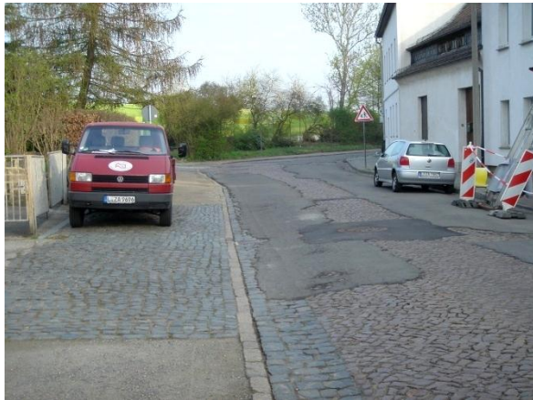
Alte Straße Sanierungsbedarf
