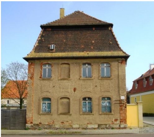
Hauptstraße 313 nördliches Torhaus mit Sanierungsbedarf
