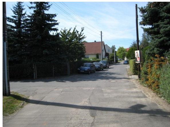
Kleine Aue Anliegerstraße mit Sanierungsbedarf
