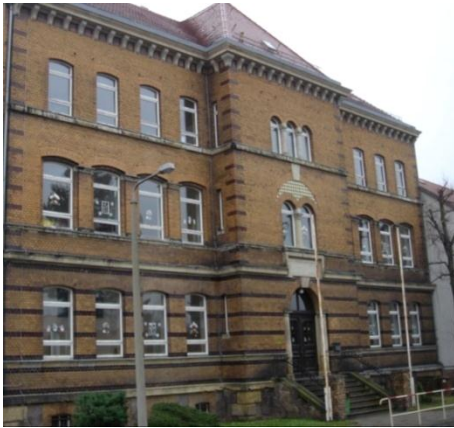
Alte Straße 7 Grundschule Großstädteln mit Sanierungsbedarf
