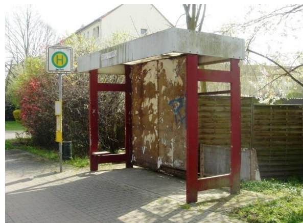
Bushaltestelle „Am Park“ Handlungsbedarf Haltestellenhaus
