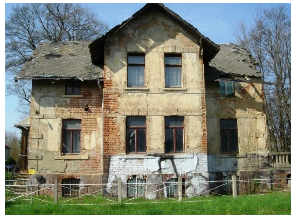
Schachtweg 3 Missstand, Handlungsbedarf
