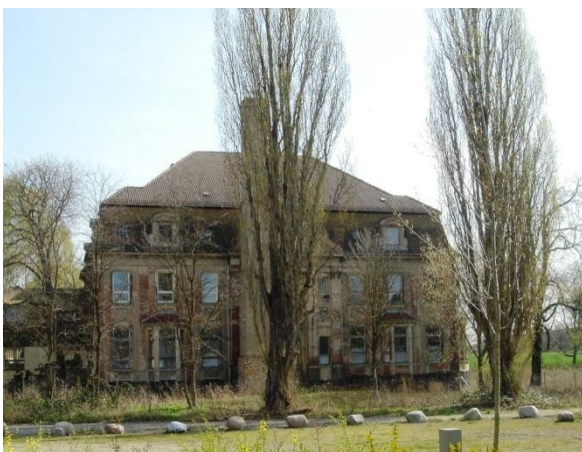
Cröbernsche Straße 12a, Neues Herrenhaus Gaschwitz, ehemals Schule, jetzt Leerstand und ruinöse Bausubstanz
