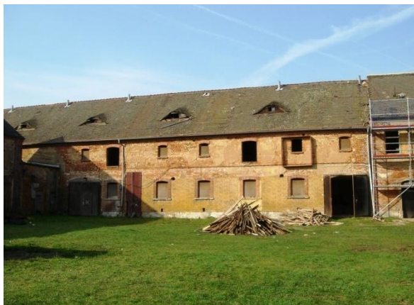
Hauptstraße 219 Speicher mit Handlungsbedarf
