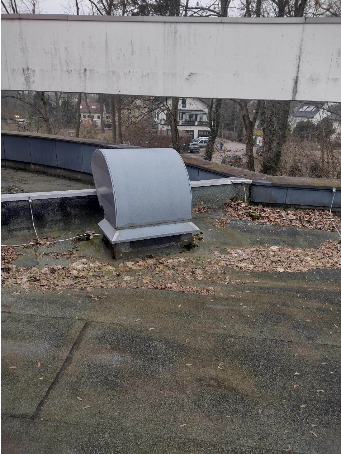
Lfd. Nr.: 17 Datum: 09.04.2025 Bem.: Dach Halle - verschlissene Abdichtung
