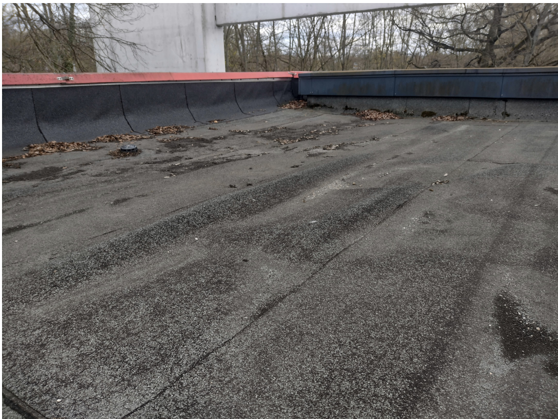
Lfd. Nr.: 10 Datum: 09.04.2025 Bem.: Dachfläche Halle - Blasenbildung
