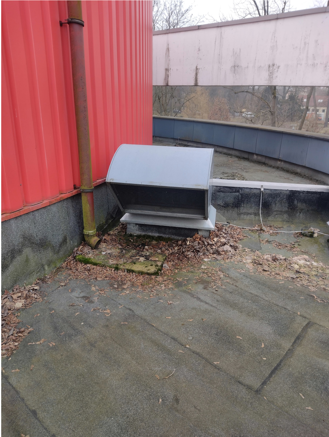
Lfd. Nr.: 16 Datum: 09.04.2025 Bem.: Dach Halle – verschlissene Abdichtung
