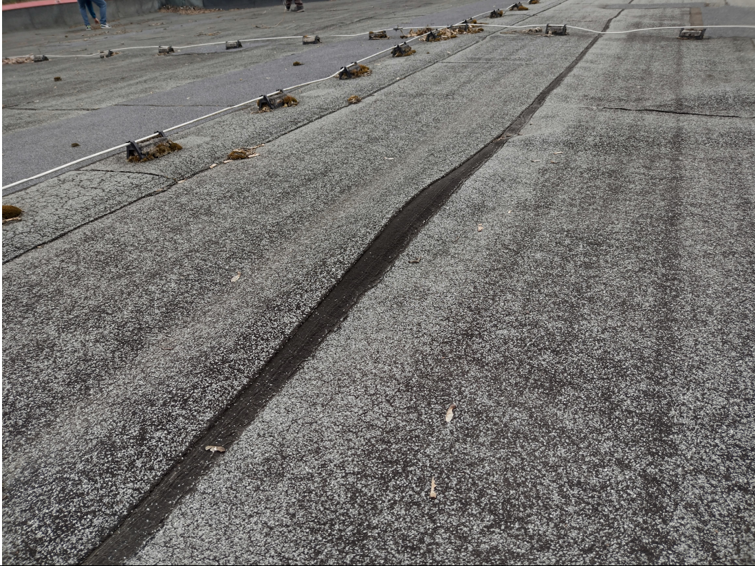
Lfd. Nr.: 05 Datum: 09.04.2025 Bem.: Dachfläche Halle - Blasenbildung
