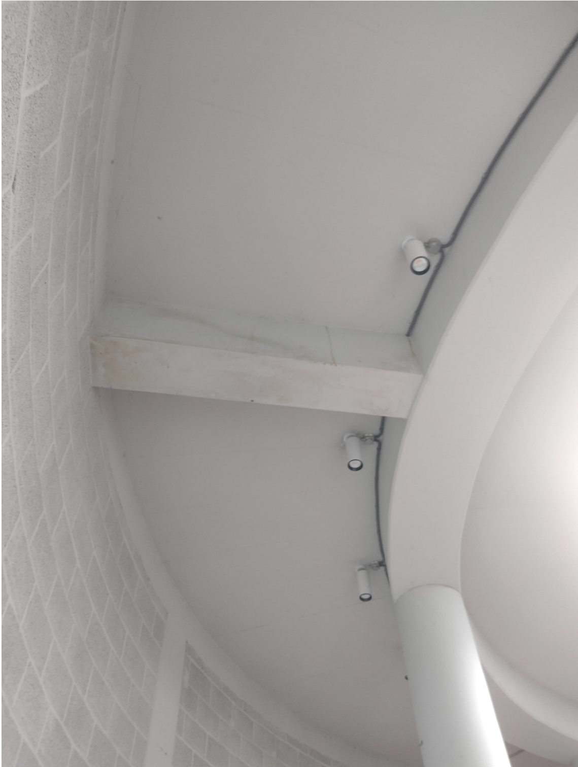
Lfd. Nr.: 22 Datum: 09.04.2025 Bem.: Rundbau (Rotunde) – Wasserschäden innen
