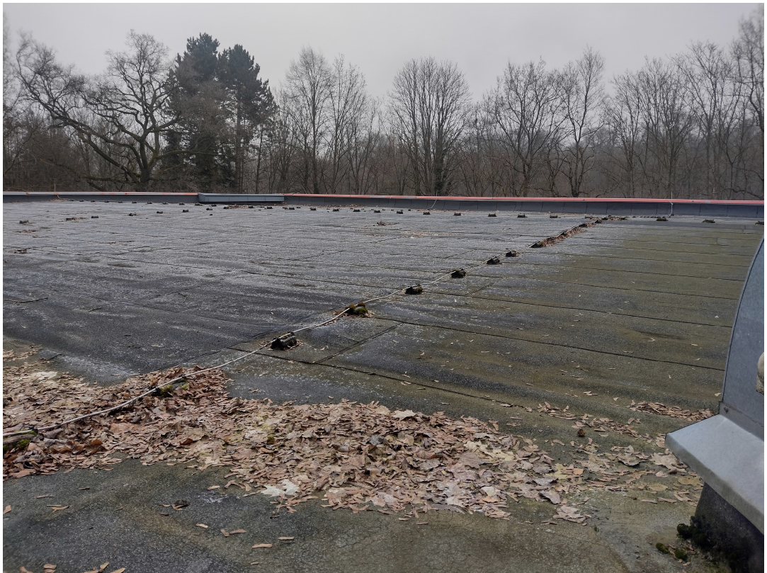
Lfd. Nr.: 04 Datum: 09.04.2025 Bem.: Dachfläche Halle – Blasen + Hohlstellen
