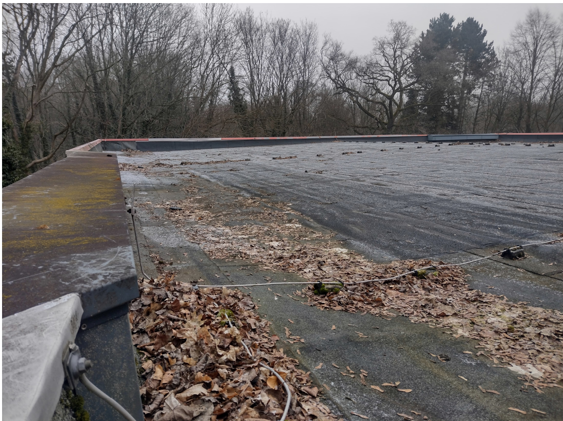
Lfd. Nr.: 02 Datum: 09.04.2025 Bem.: Dachfläche Halle – Blasen + Hohlstellen
