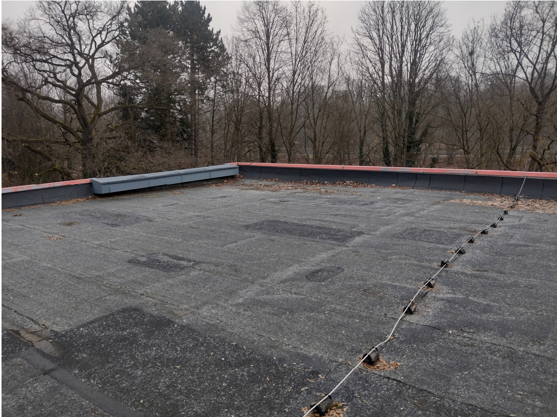
Lfd. Nr.: 11 Datum: 09.04.2025 Bem.: Dachfläche Halle - Blasenbildung
