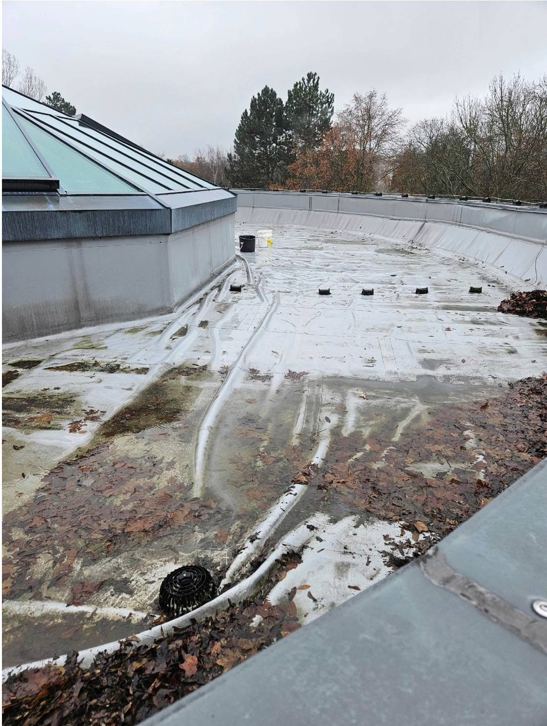
Lfd. Nr.: 21 Datum: 09.04.2025 Bem.: Dachfläche Rundbau - Lageverschiebungen
