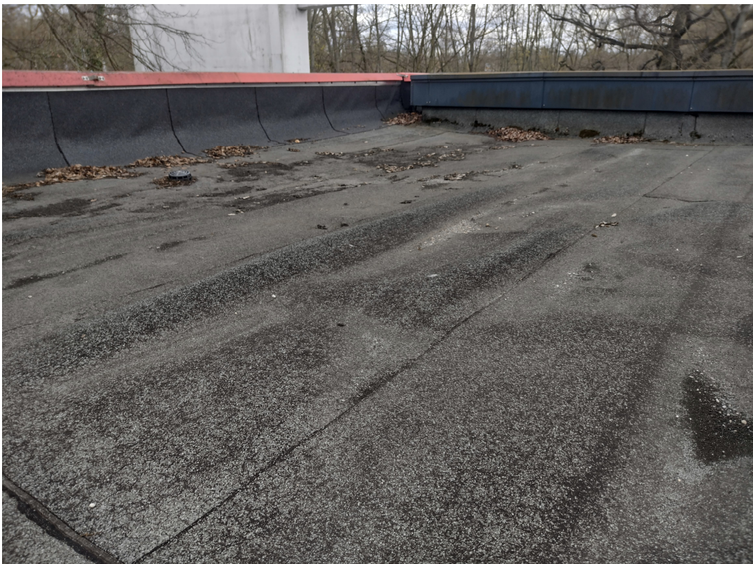
Lfd. Nr.: 08 Datum: 09.04.2025 Bem.: Dachfläche Halle - Blasenbildung
