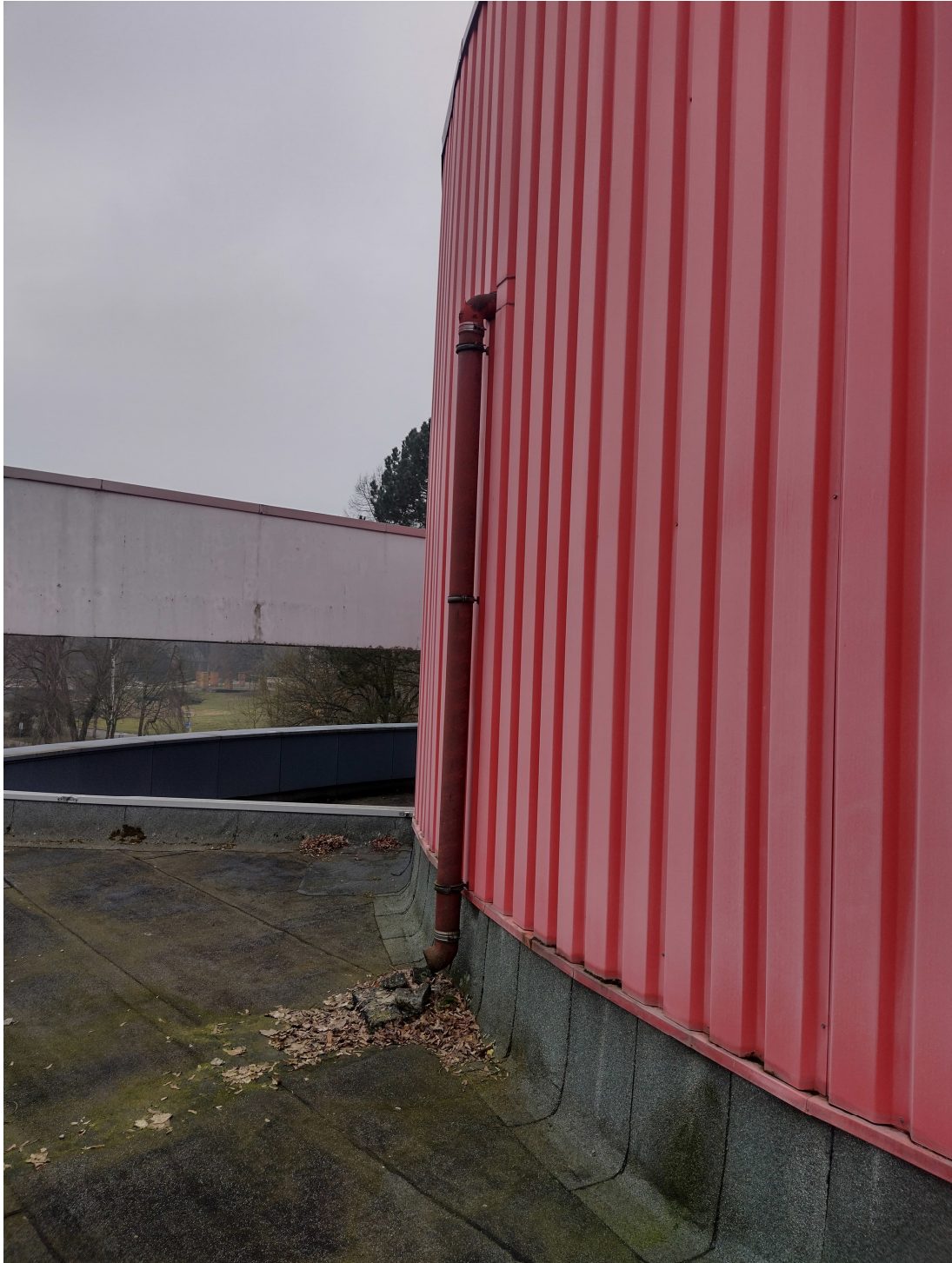
Lfd. Nr.: 15 Datum: 09.04.2025 Bem.: fehlender Notüberlauf Rotunde
