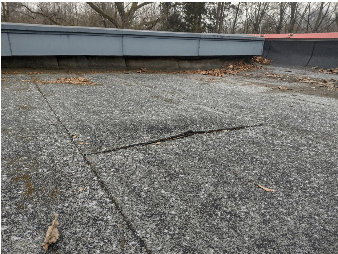
Lfd. Nr.: 12 Datum: 09.04.2025 Bem.: Dachfläche Halle - Blasenbildung
