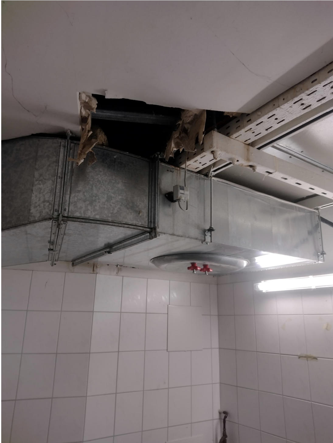
Lfd. Nr.: 18 Datum: 09.04.2025 Bem.: Halle Nebenraum - Wasserschaden innen
