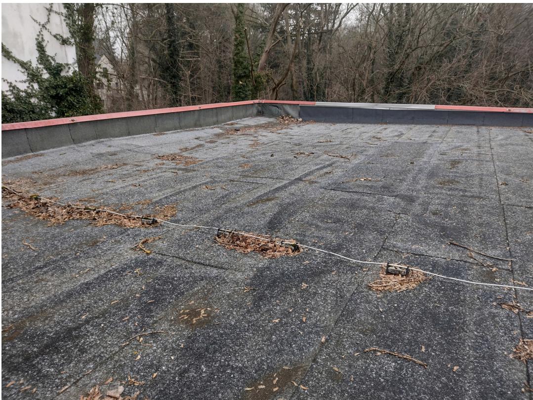
Lfd. Nr.: 06 Datum: 09.04.2025 Bem.: Dachfläche Halle – Blasenbildung
