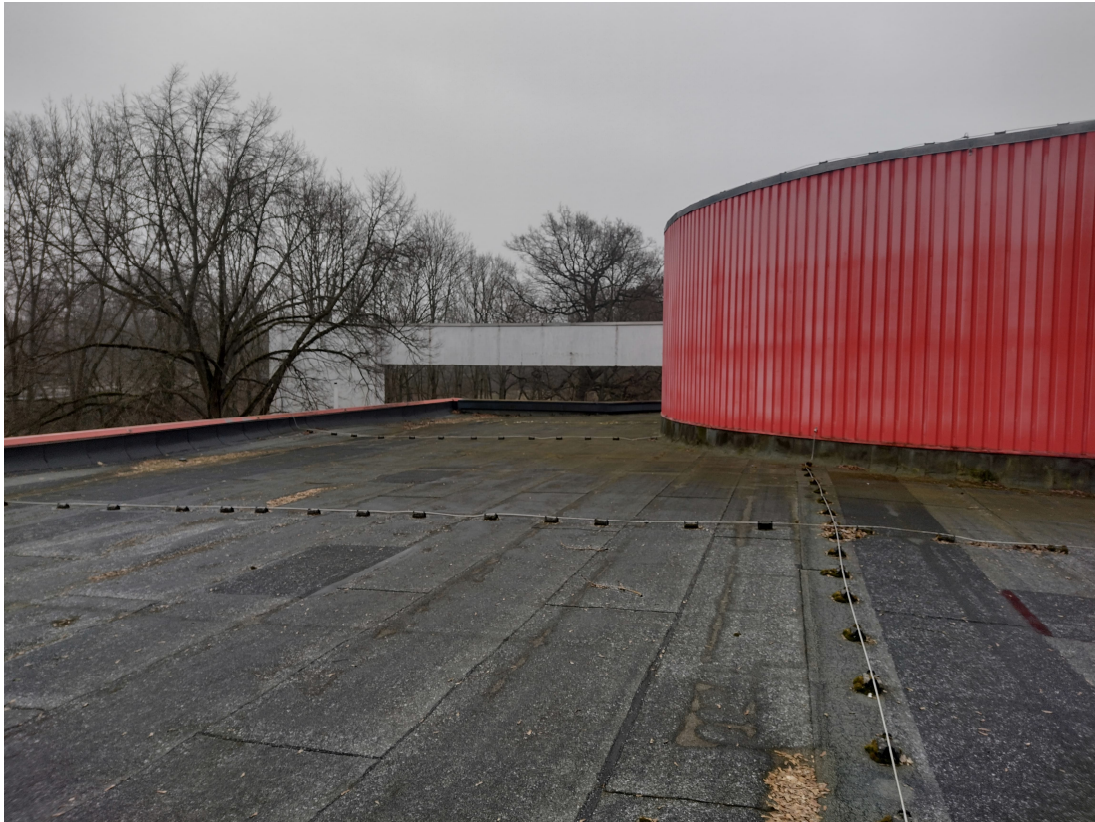
Lfd. Nr.: 09 Datum: 09.04.2025 Bem.: Dachfläche Halle – fehlende Notüberläufe
