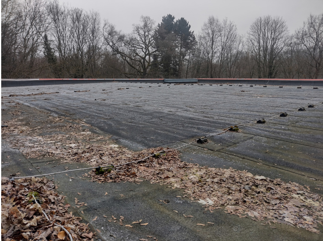
Lfd. Nr.: 03 Datum: 09.04.2025 Bem.: Dachfläche Halle – Blasen + Hohlstellen
