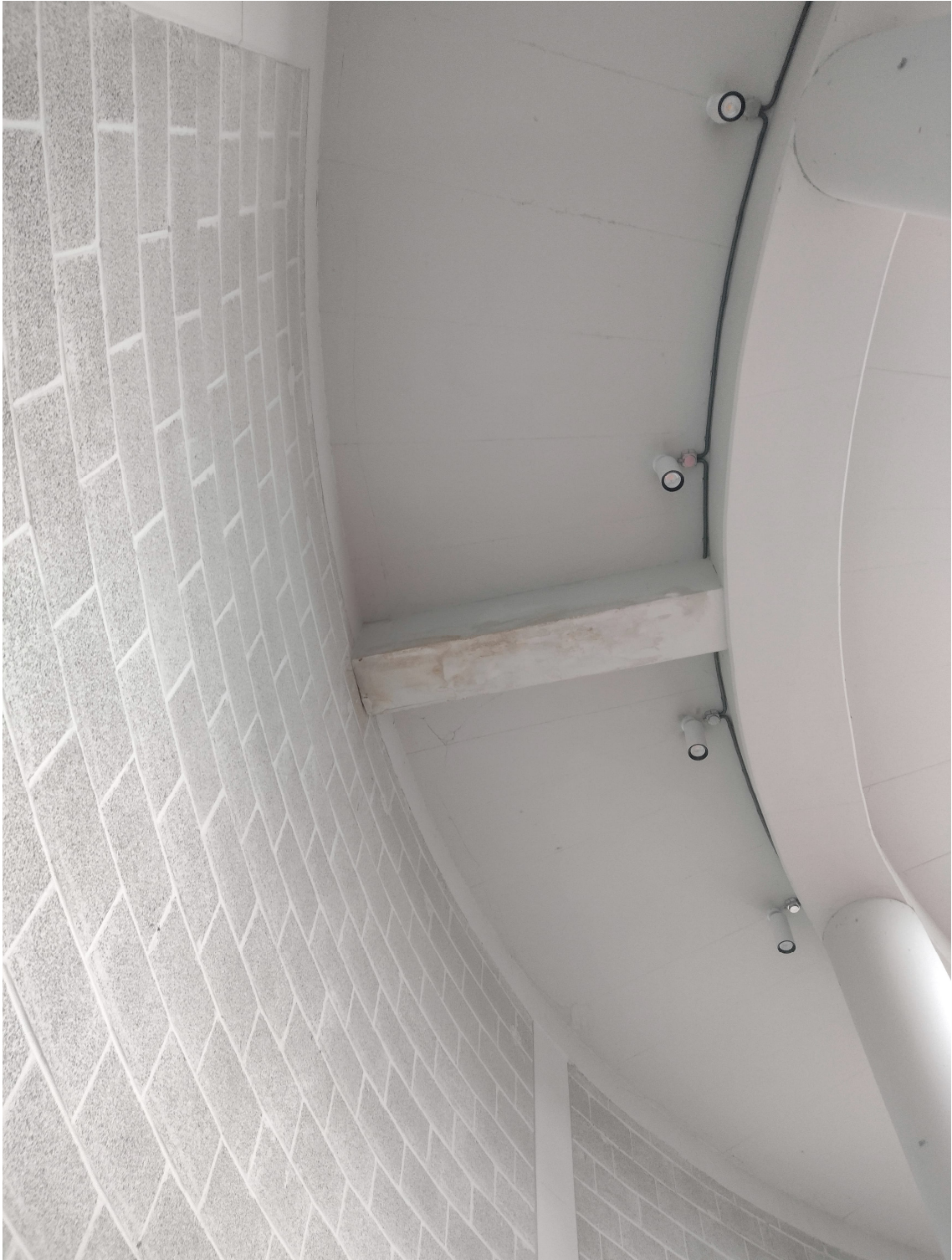
Lfd. Nr.: 23 Datum: 09.04.2025 Bem.: Rundbau (Rotunde) – Wasserschäden innen
