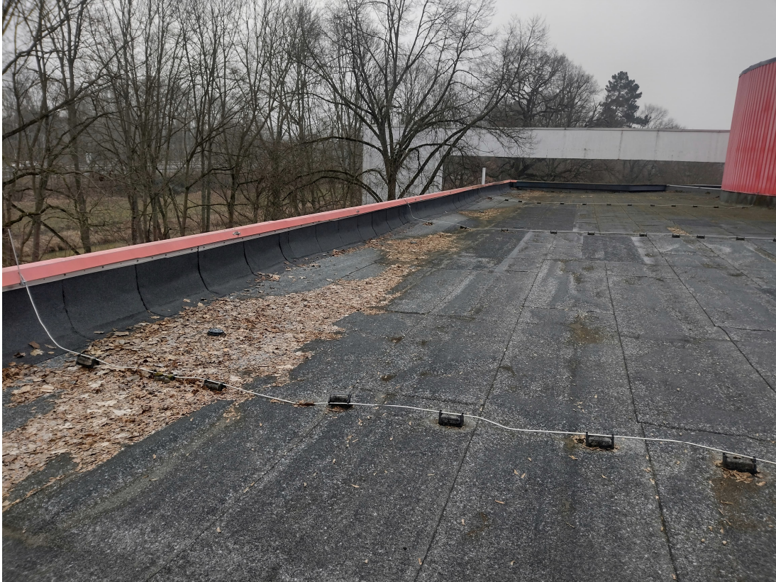
Lfd. Nr.: 13 Datum: 09.04.2025 Bem.: Dachfläche Halle – fehlende Notüberläufe
