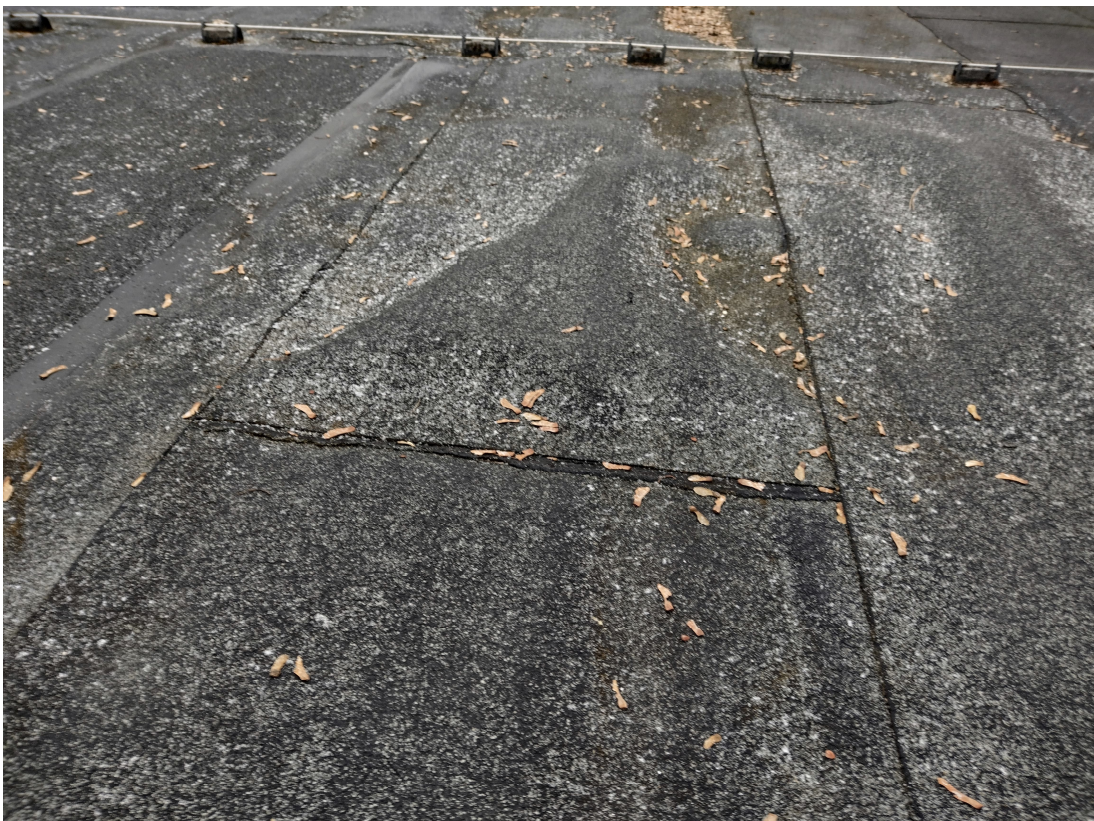
Lfd. Nr.: 14 Datum: 09.04.2025 Bem.: Dachfläche Halle - Blasenbildung
