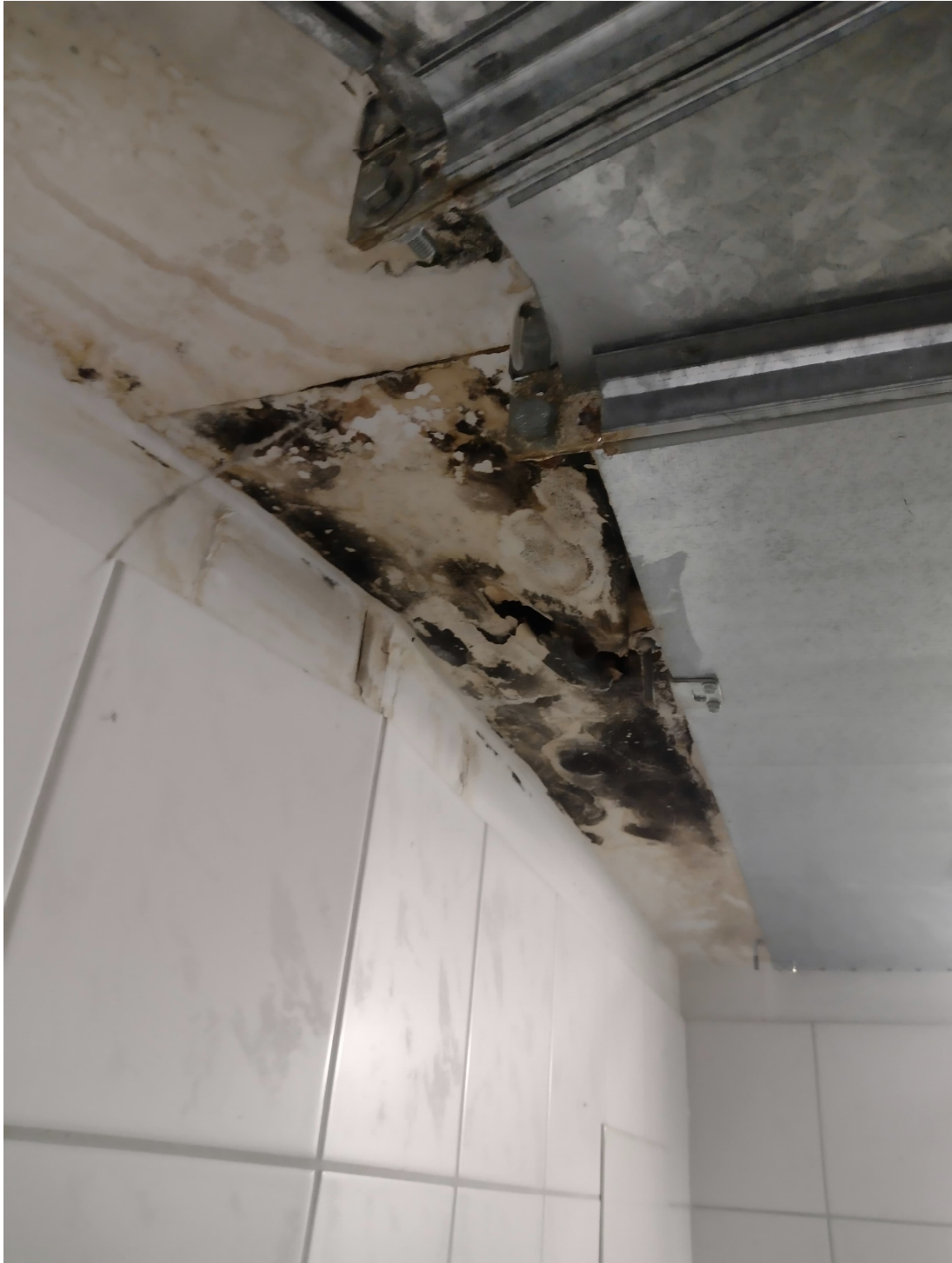
Lfd. Nr.: 19 Datum: 09.04.2025 Bem.: Halle Nebenraum – Wasserschaden innen
