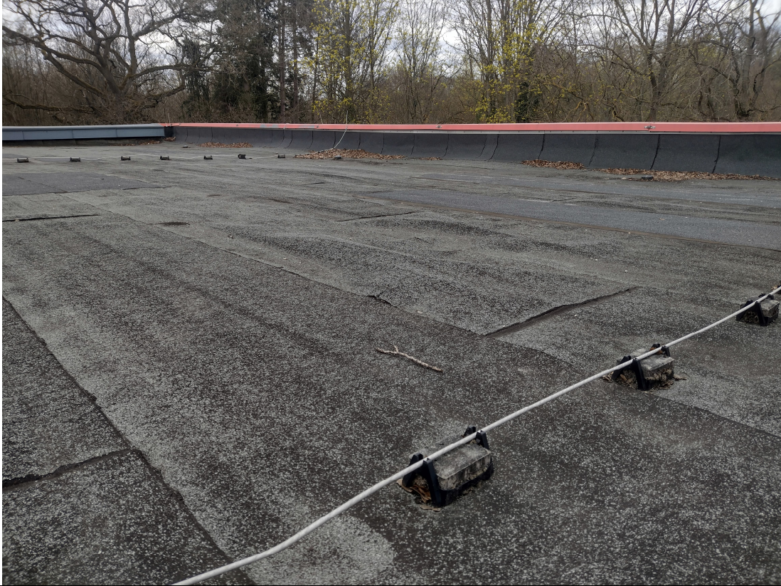
Lfd. Nr.: 07 Datum: 09.04.2025 Bem.: Dachfläche Halle Blasenbildung
